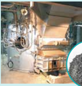
多治見市三の倉センター溶融炉
